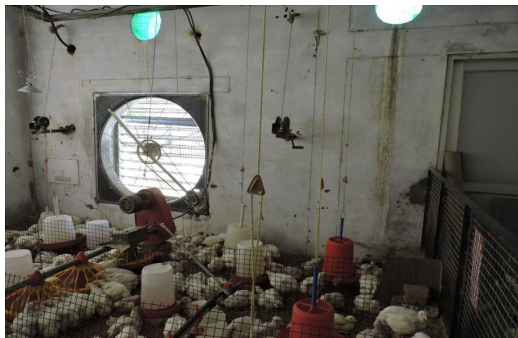
Picture 3: Exhaust Fan
