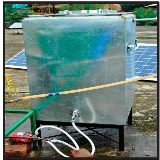
(d) Hot water storage tank
